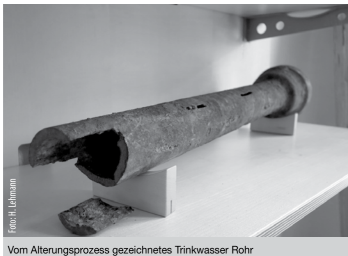
Vom Alterungsprozess gezeichnetes Trinkwasser Rohr
